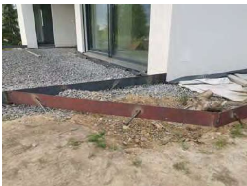
Obr. 8 Ukázka lemové obruby z ocelové pásoviny a kotvení pomocí trnů/rotorů (převzato z: www.zahradysnapady.cz)
